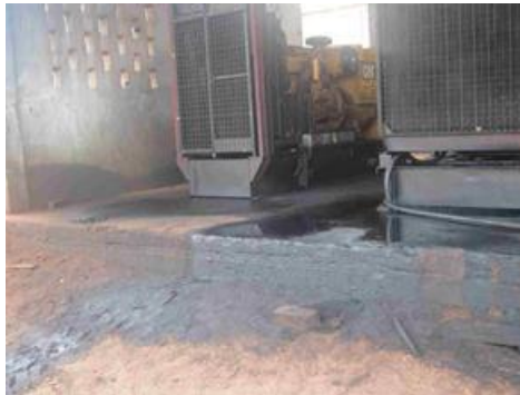
Photo 33 : Déversements accidentels observés au niveau des groupes électrogènes
