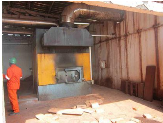
Photo 17 : Vue de la chaudière installée sur le site de Moualé
