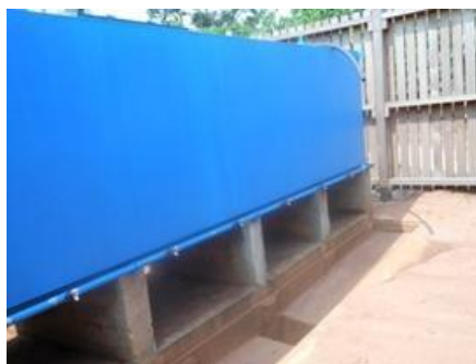
Photo 4 : Citerne d'eau potable installée au nouveau camp de MOUALE
