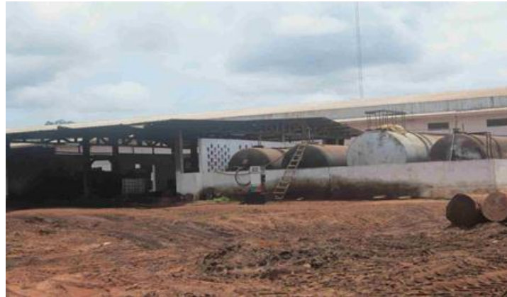
Photo 34: Proximité entre groupes électrogènes et zone de dépotage à Moualé
